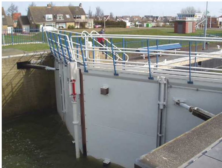
FIGURE 11.7 – Portes d'écluses et vérins
