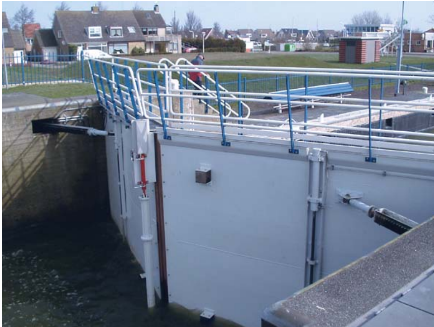
Figure 2 – Portes d'écluses et vérins
