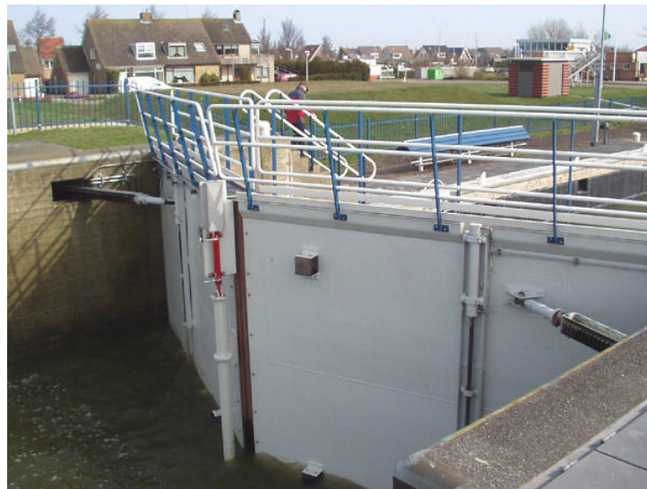
FIGURE 11.14 – Portes d'écluses et vérins
